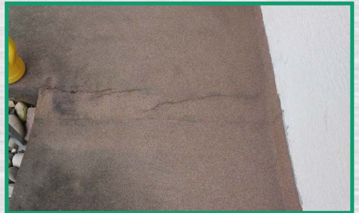
Risse im Steinteppich
