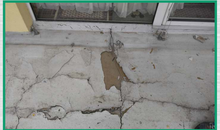
Flüssigbeschichtung blättert ab
