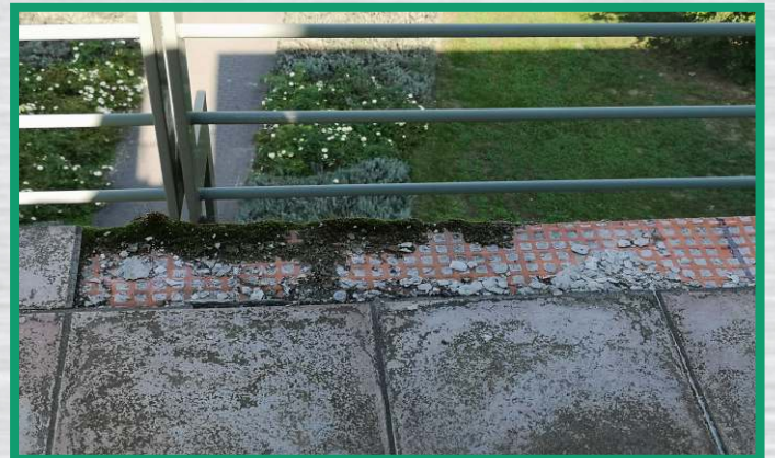
Klassische Sanierung nach nur 7 Jahren
