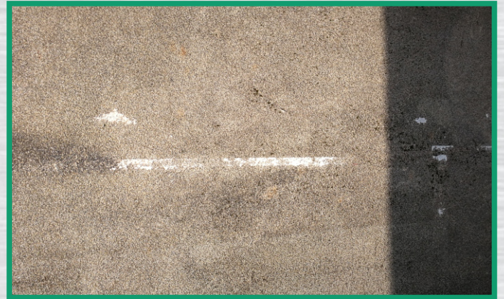
Steinteppich verliert Steine - hier 80 m 2
